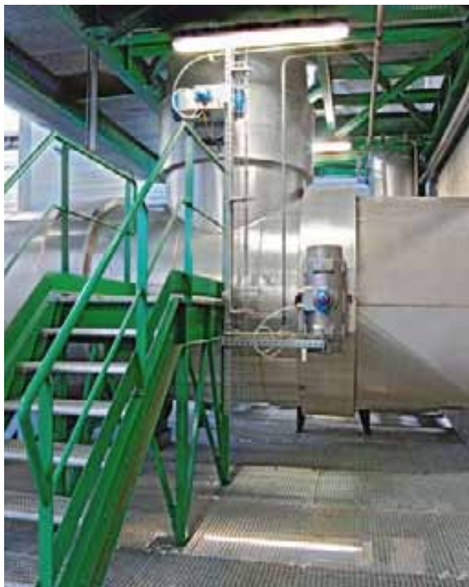
Installation d'incinération de déchets Intradel, Herstal, Belgique
