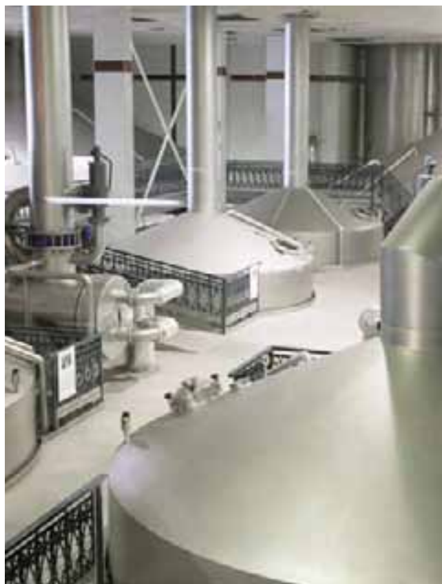
Isolation de qualité hygiénique dans une salle des chaudières de brassage en Bavière
