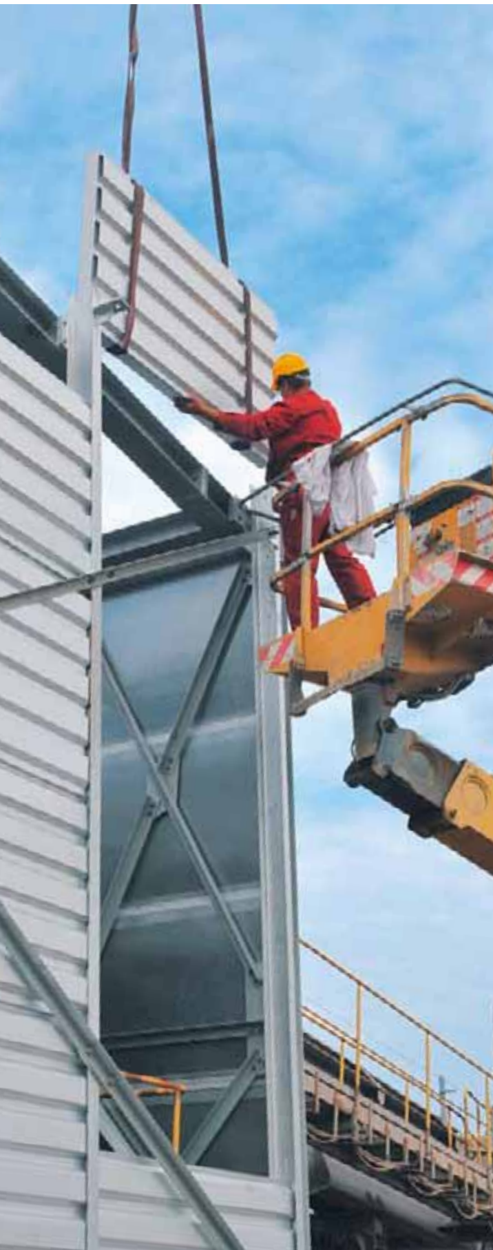
Capot d'insonorisation sur un poste de commande dans la mine de lignite à ciel ouvert de Schleenhain
