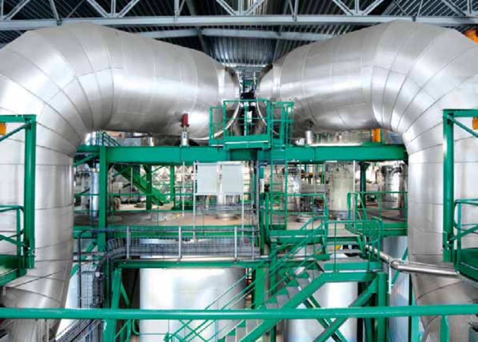
Installation d'incinération de déchets Intradel, Herstal, Belgique
