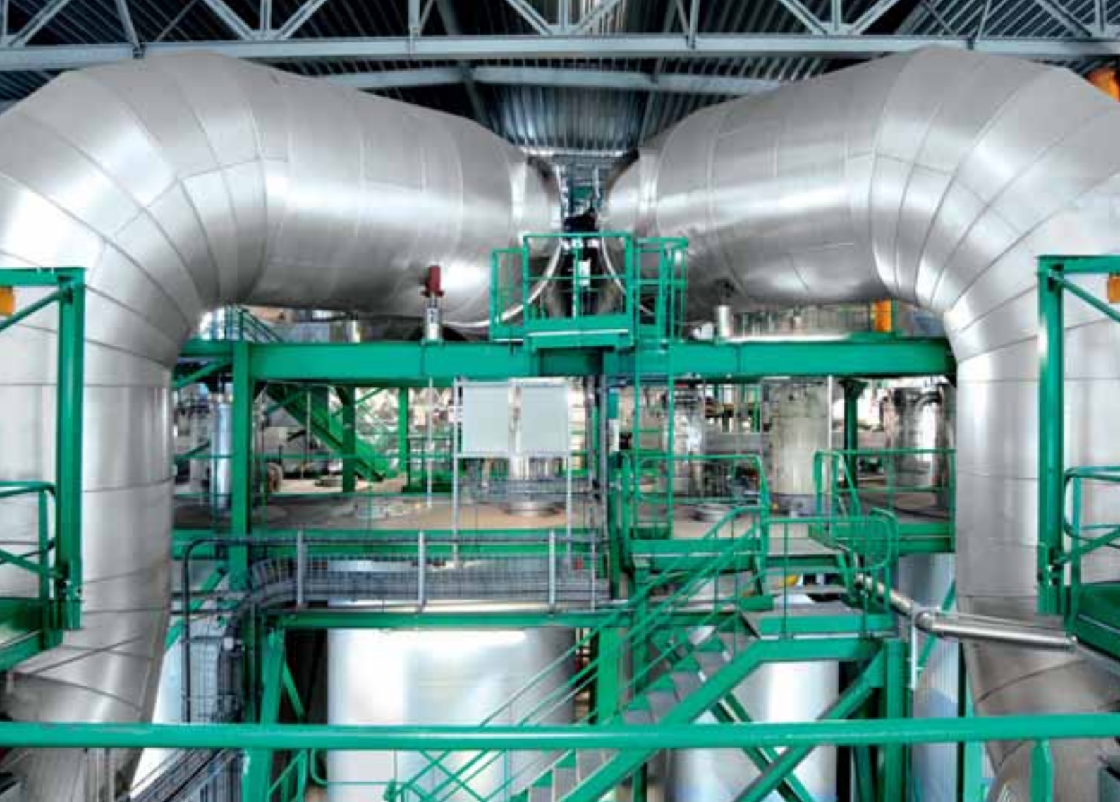
Müllverbrennungsanlage Intradel, Herstal, Belgien
