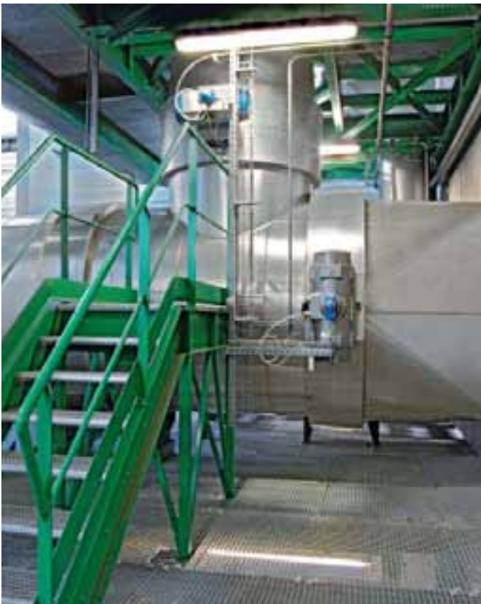
Müllverbrennungsanlage Intradel, Herstal, Belgien
