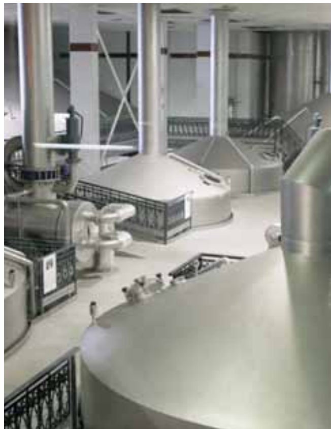
Hygienisch einwandfreie Isolierung in einem Sudkesselhaus in Bayern
