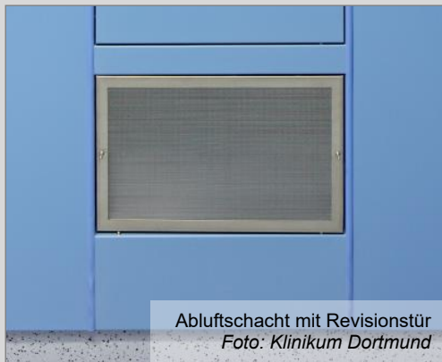
Abluftschacht mit Revisionstür Foto: Siloah Hannover
