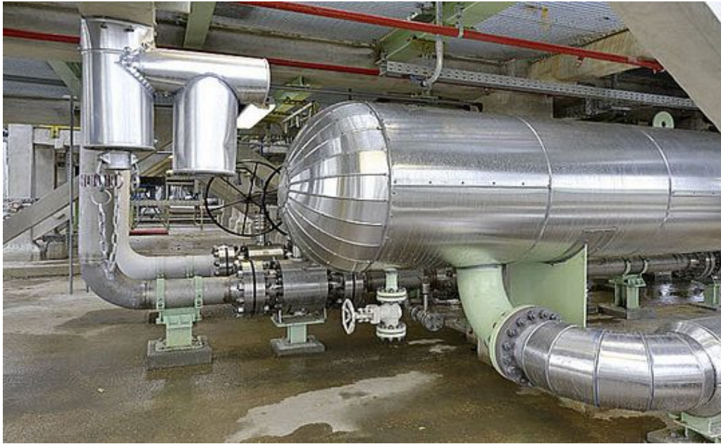
Produits mis en oeuvre: Industrial insulation
